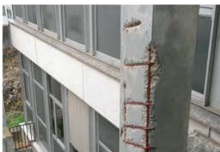
Bê tông bị hư hại
